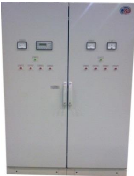
Рис. 16. Шкаф оперативного тока (ШОТВ)
