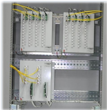
Рис. 6. Блоки активного оптического сплитера и оптического коммутатора
