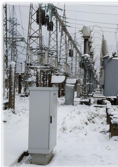
Рис. 10. Шкаф кроссовый на ОРУ ПС Радищево
