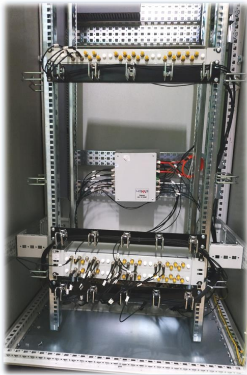
Рис. 11. Шкаф связи с оптическим коммутатором в ОПУ ПС Радищево
