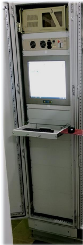
Рис. 12. Шкаф АСУ в ОПУ ПС Радищево
